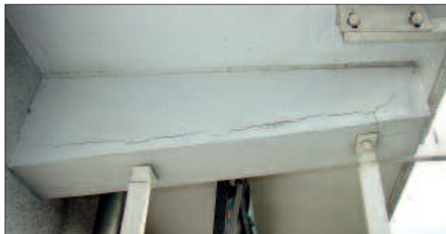
■ Rissbildungen wie an Kragbalken treten selbst bei Gebäuden auf, die erst in den 1990-er Jahren instand gesetzt worden sind.
